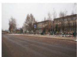
Dofinansowania dla starostwa - przebudowa dróg, chodników, parkingów w ulicach: Kilińskiego, Paderewskiego, Kościuszki, Marcinkowskiego, Północnej, Wyzwolenia, Plac Wolności - łącznie 450 tys zł
