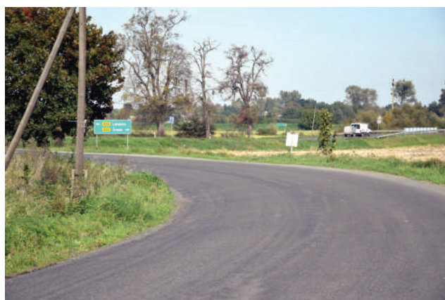
Ponad 78 tys. złotych to koszt położenia masy bitumicznej na drodze powiatowej - od drogi wojewódzkiej 432 do Miąskowa.
