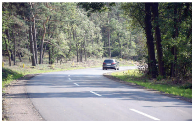
Przebudowywany w pierwszym etapie odcinek z Żelazna do Stankowa ma blisko 2,2 km długości.
